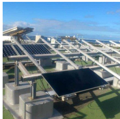
Banc d'exposition de cellules voltaïques © site internet Projet Durasol
